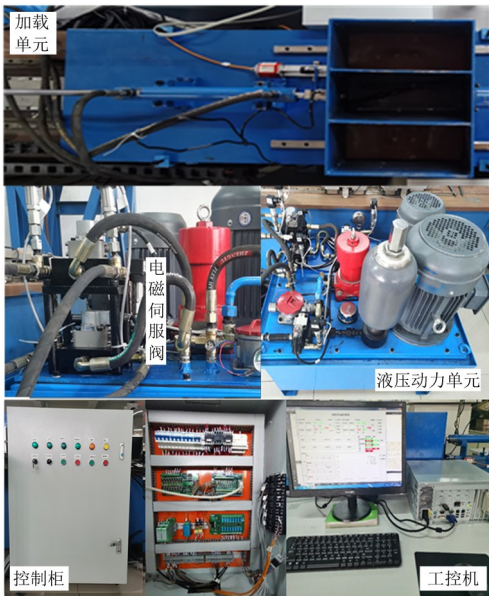
图6 液压系统控制平台
